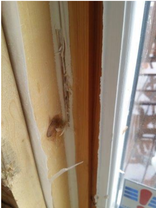
Ísetning og frágangur glugga er rangur. Að auki hefur rakavarnarlag ekki verið þétt að gluggakarmi.
