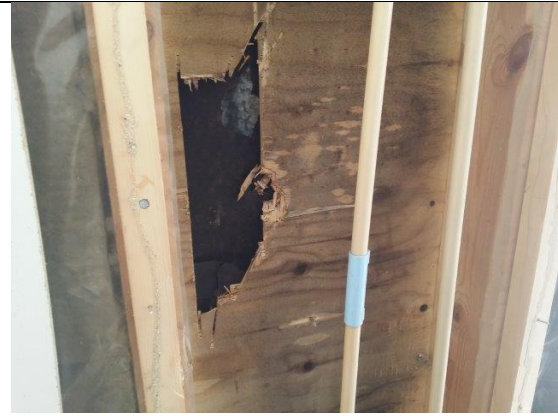
Ummerki um myglu í vegg viðbyggingar að garði.
