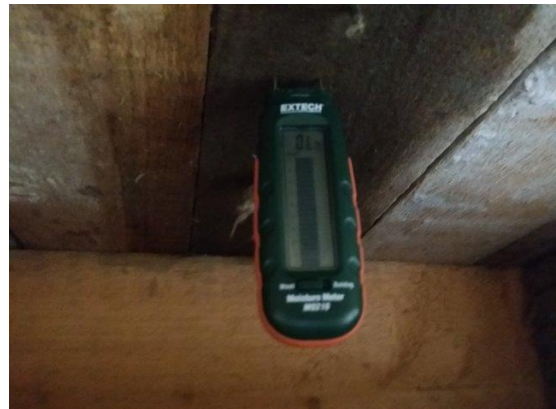
Mikil mygla og hátt rakastig er í þaki viðbyggingar.
