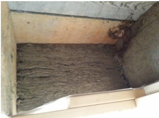
Frágangur á steinull í þaki millibyggingar. Hér vantar alla loftun.
